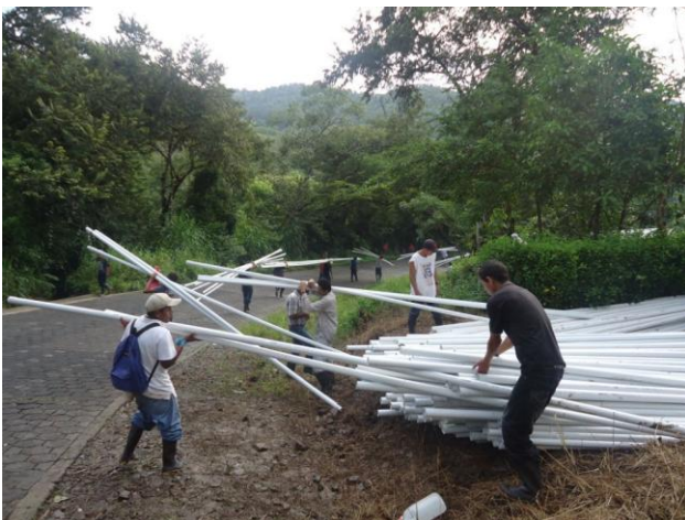
Wasserleitungen für El Tuma
